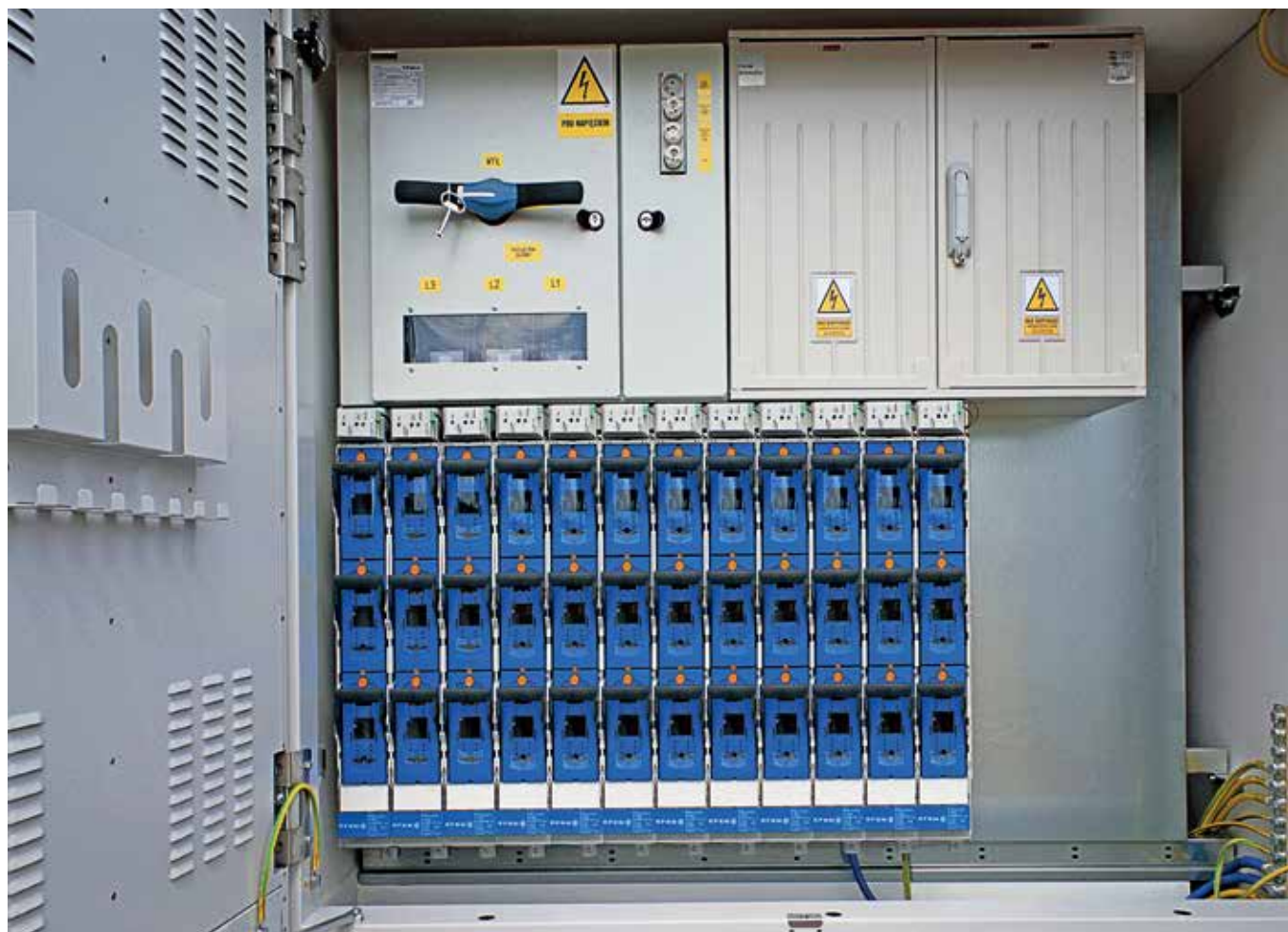
Zdj. 15. Przykład rozłączników bezpiecznikowych NSL E3 z kontrolą przepalenia wkładek bezpiecznikowych w stacji transformatorowej produkcji PKI WILK
